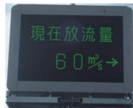
放流警報表示板 (上中) (他3箇所)
