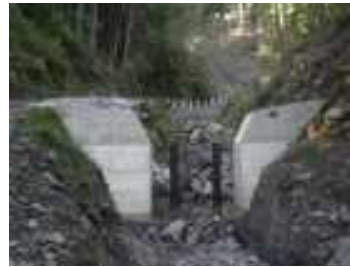
流木を補足する流木捕捉式治山ダム工
