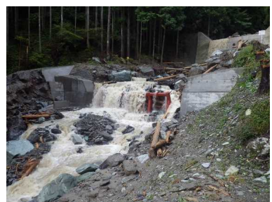
流木を補足した流木捕捉式治山ダム工
