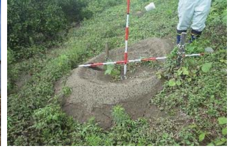
漏水箇所の写真(H26年8月)
