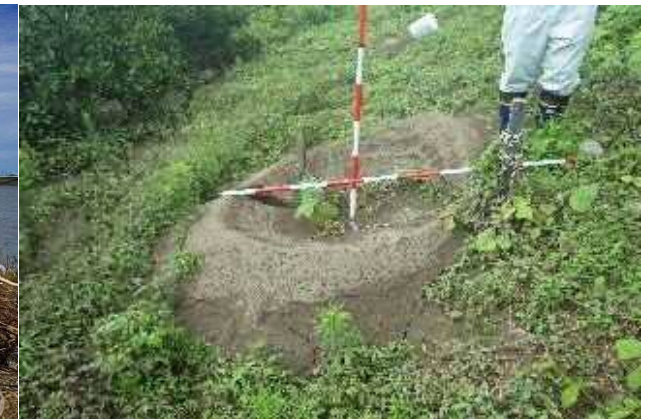
漏水箇所の写真(H26年8月)
