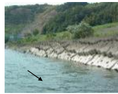
局所洗掘の発生
