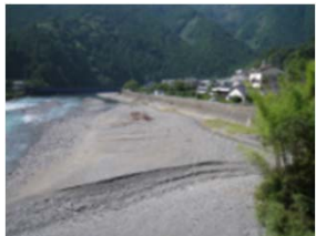
河床の上昇 (出原橋下流)
