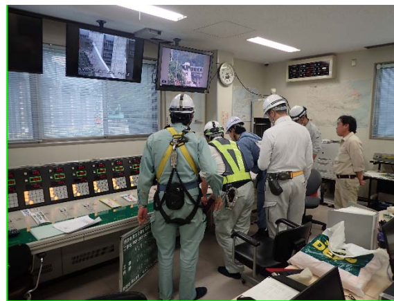
ゲート遠方操作確認
