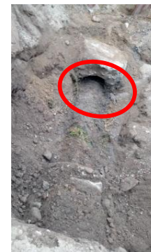
横断水路継ぎ目部に隙間が発生
