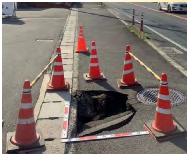
地下埋設物に起因する歩道の陥没
