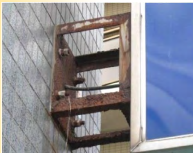
ブランケットの腐食による落下の危険のある看板 (国土交通省HPより)
