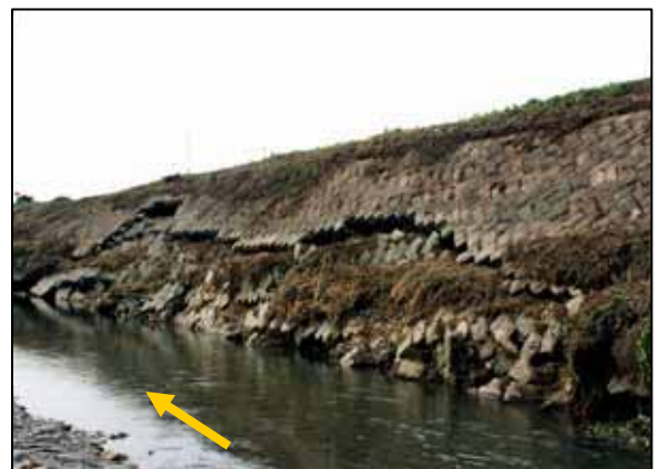
平成 9 年 7 月洪水での護岸崩壊 （松山市古川地先：重信川 河口より 6.1km 付近松山市側）
