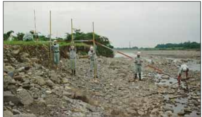
洪水による護岸崩壊(H13.6) (東温市上村地先：重信川 河口より 14.4km 付近東温市南側)
