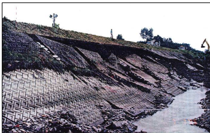
被災状況（平成7年7月洪水） （東温市牛渚地先：重信川 河口より14.6km付近 東温市北側）
