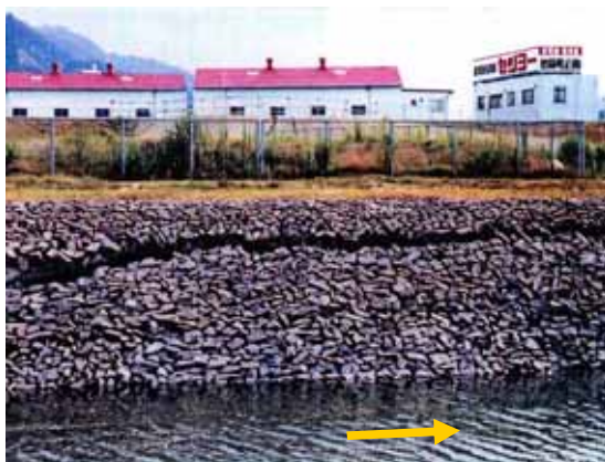
平成 8 年 7 月洪水での護岸崩壊 （砥部町八倉地先：重信川 河口より 7.9km 付近砥部町側）
