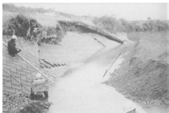
偏流による護岸崩壊(S55) (重信川 河口より5.2km 付近松山市側)
