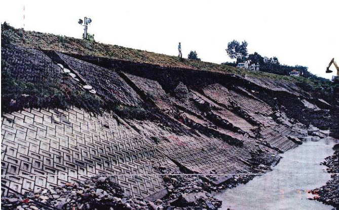
被災状況（平成7年7月洪水） （東温市牛渚地先：重信川 河口より14.6km付近 東温市北側）
