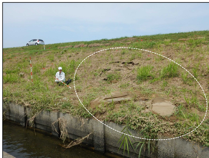
平成29年9月洪水による漏水箇所 (左岸3k600+160付近)
