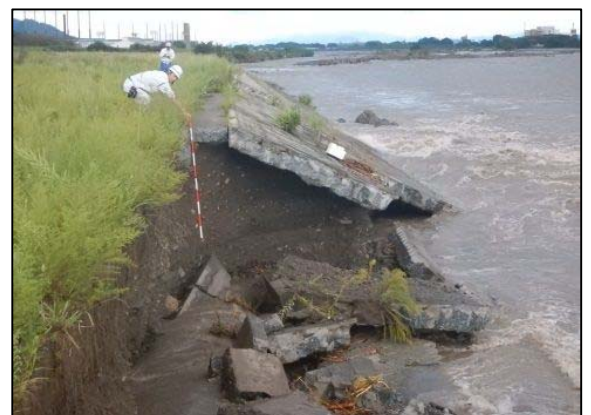
平成 29 年 9 月洪水(13.6k 左岸付近)
