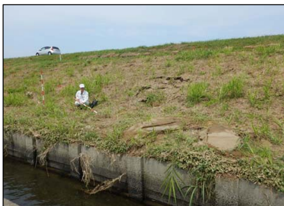
平成 29 年 9 月洪水(3.8k 左岸付近)
