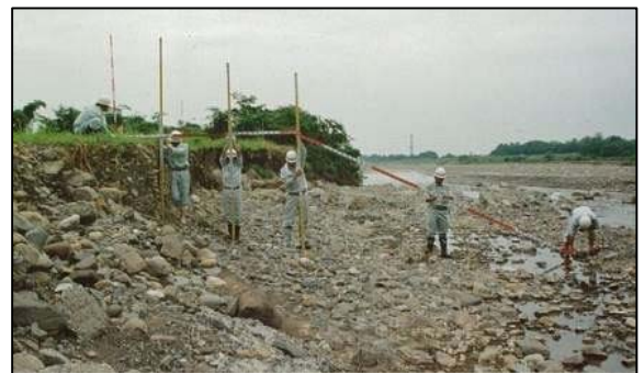
平成 13 年 6 月洪水(14.4k 左岸付近)
