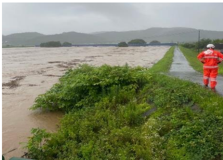
津谷地区の浸水被害 堤防の監視
