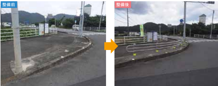
交通事故防止を目的に交差点にガードパイプを設置 (事例紹介：四国中央市土居町上野)
