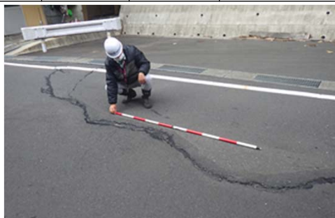
⑦県道32号にクラックが発生(令和3年)
