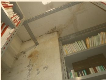
天井・内壁：書庫の天井にひび割れが発生し、屋根からの漏水により、塗装が剥離
