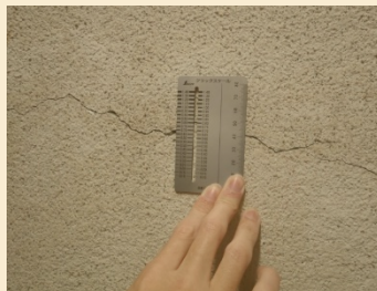
内壁：書庫の壁にひび割れが発生
