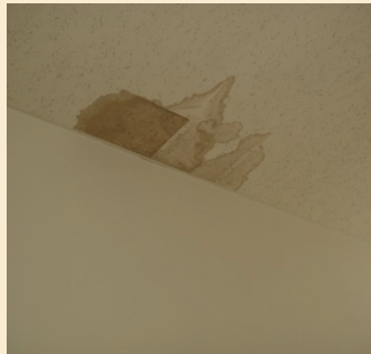
天井：事務室に漏水が発生
