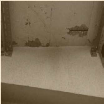
天井：2階床下の鉄筋が腐食し、コンクリートの爆裂が発生
