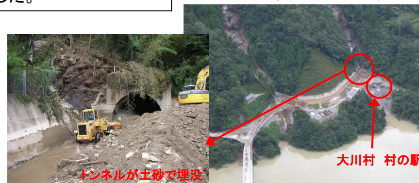
写真-2-2 土砂災害発生状況
