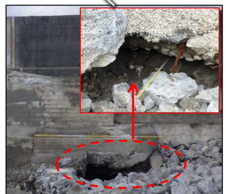
②基礎部分の空洞化状況
