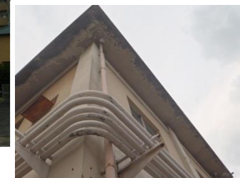
外部の劣化状況 10
