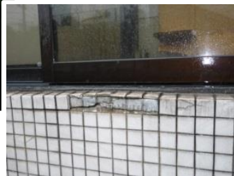
外部の劣化状況
