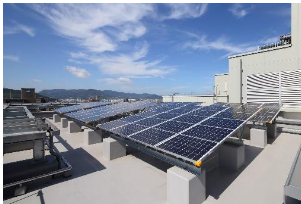
太陽光発電設備
