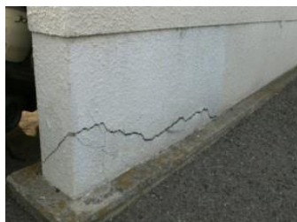
外部の劣化状況
