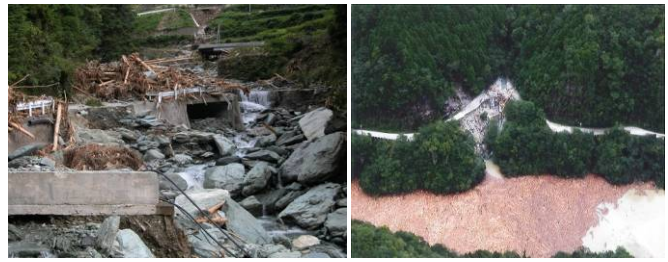
写真 31 流木による被害状況
