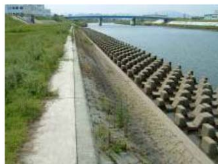
根固ブロック等による景観の悪化
