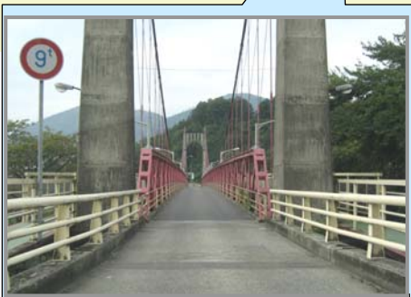
美濃田大橋(S39供用) 橋脚の破損により、通行不能になる危険性がある。
