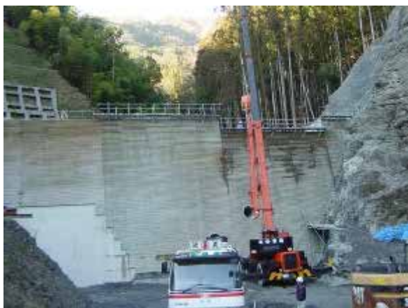
写真-22 第3久保谷えん堤
