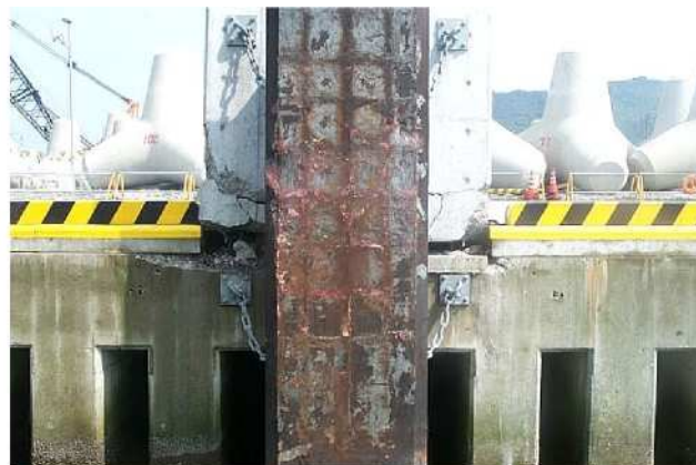
防舷材破損状況
