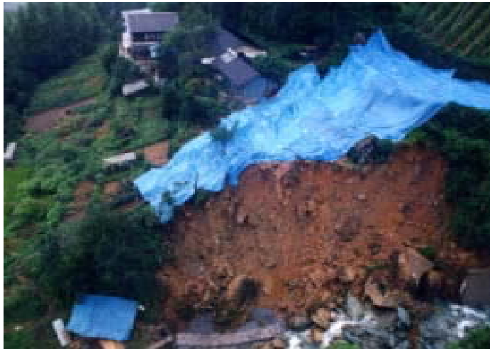
写真 - 6 平成 2 年台風 1 4 号による さがやま 佐賀山地区の被害状況（南小川）
