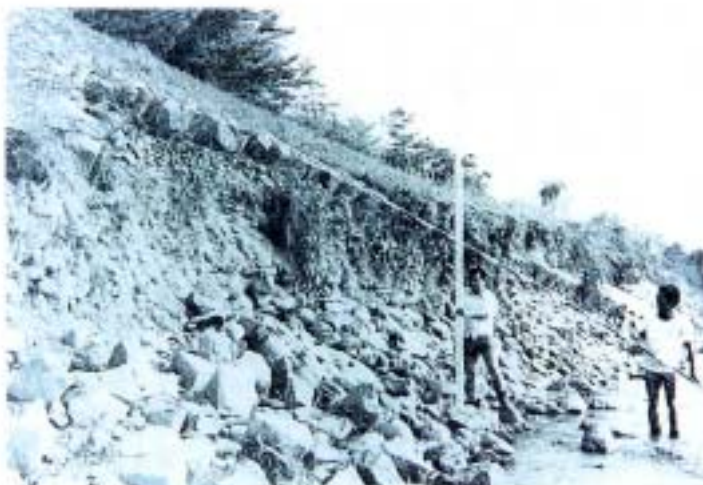
S. 50 台風 6 号による出水は、戦後最大の洪水となり、随所で甚大な河道災害をもたらした。(11K5 左岸堤防の堤脚洗堀状況)
