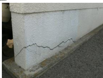
外部の劣化状況
