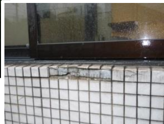
外部の劣化状況
