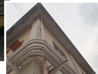
外部の劣化状況 10
