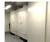
自家発電機 (エネルギーセンター内)
