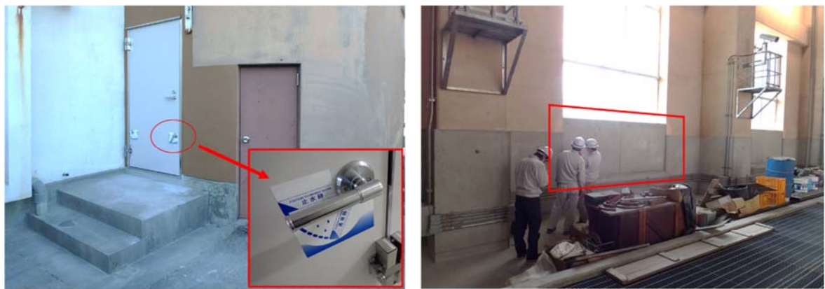
図-2-3-26 宇治川排水機場建屋の耐水化（左：止水ドア、右：止水壁）
