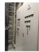
病棟1階にある配電盤
