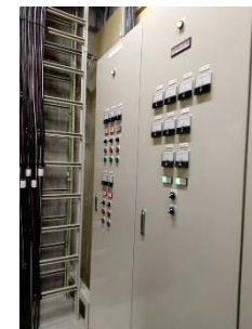
病棟1階にある配電盤
