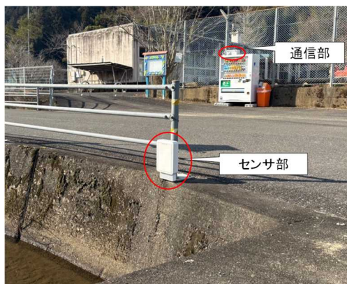
写真11-4 浸水センサ設置事例（西田地区）
