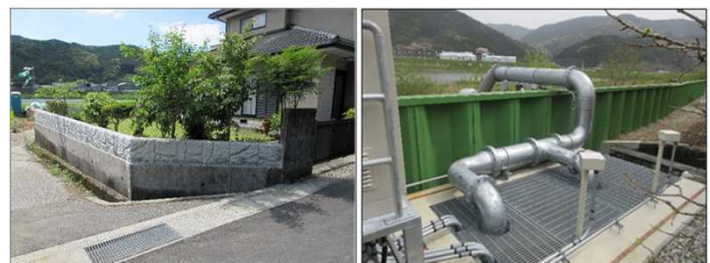
浸水防止壁と雨水排水ポンプ（馬越地区）
