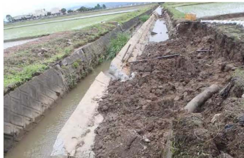
排水路の被災
