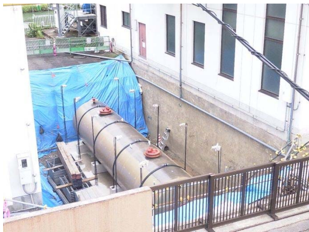
燃料タンクの設置状況
