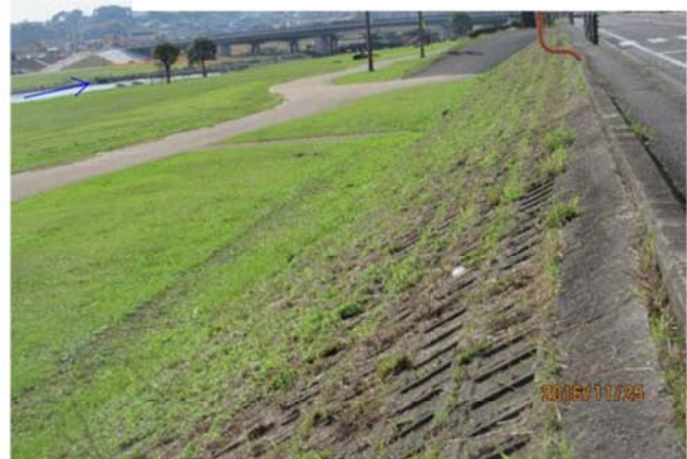
写真② 高水護岸を覆土で覆っていない箇所
