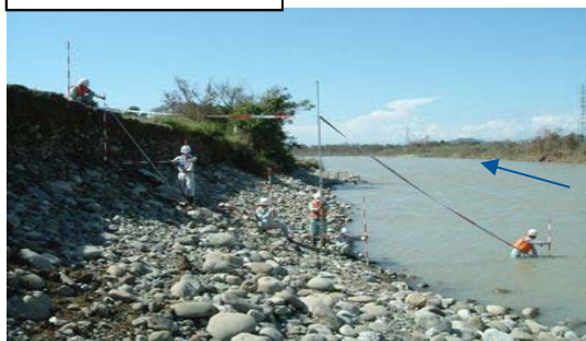
低水護岸の被災（香南市深淵地先）
