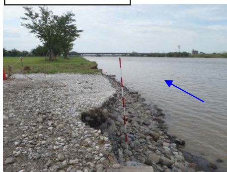
河岸の侵食（香南市深淵地先）
