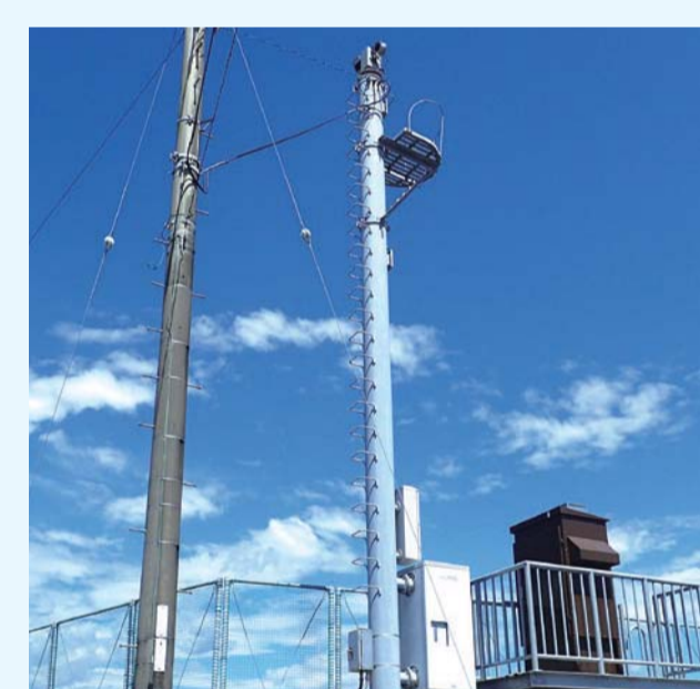
河川監視カメラ(CCTV)
