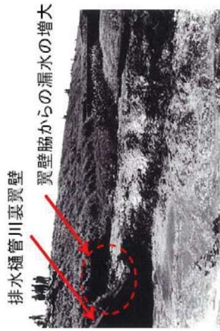
写真 - 8 排水樋管川裏翼壁からの漏水
