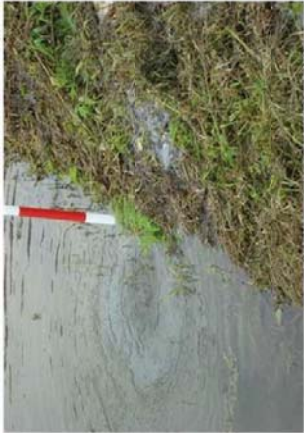
写真 - 2 法尻からの漏水の事例
