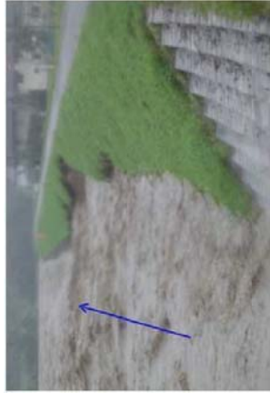
写真 - 7 表法面の侵食が発生した事例
