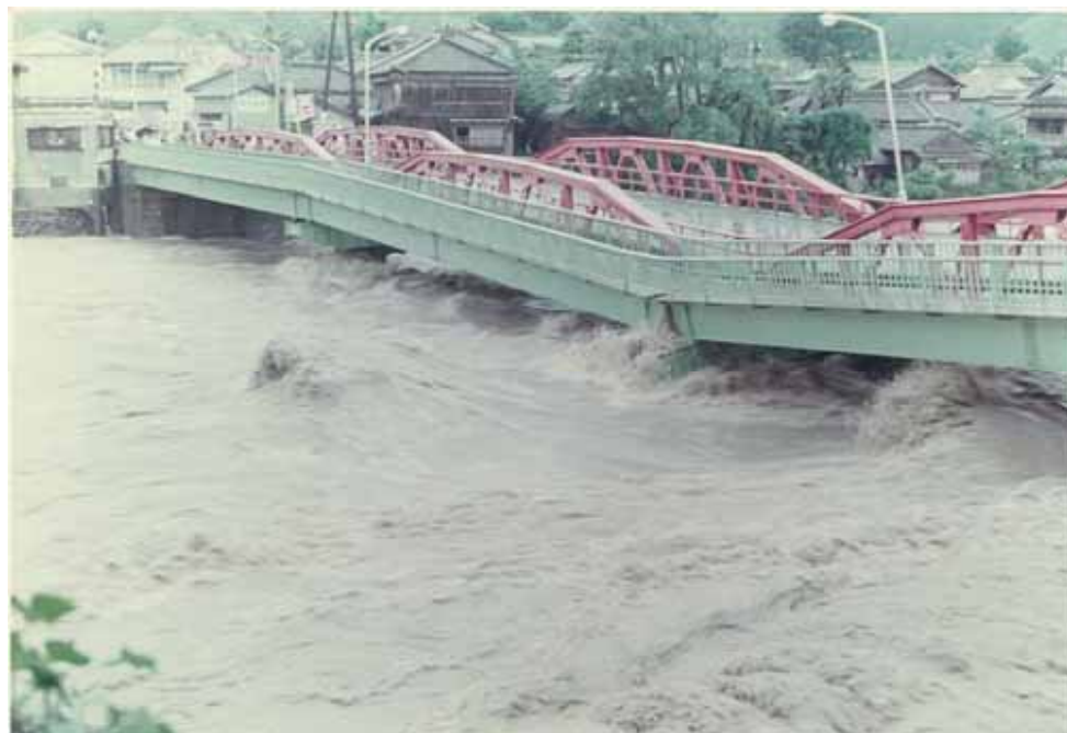
○昭和47年7月洪水 深淵流量: 約4,400m 3 /s(戦後第2位) 香我美橋の橋脚の被災
