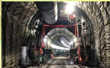
くさかがわしんすいほうすいじょ 日下川新規放水路(仮称):建設中
