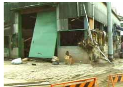
洪水流で破壊された工場
