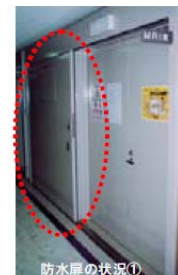
防水扉の状況①
