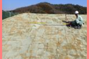
B:護岸に生じる変状
