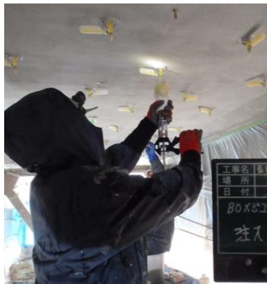
床版を増厚後、エポキシ樹脂の注入を可能にした下面増厚工「スーパーホゼン式工法」
