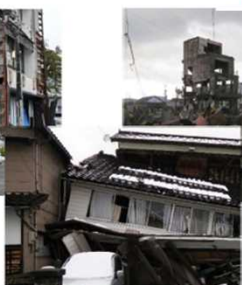
木造建築物の倒壊状況（穴水町）
