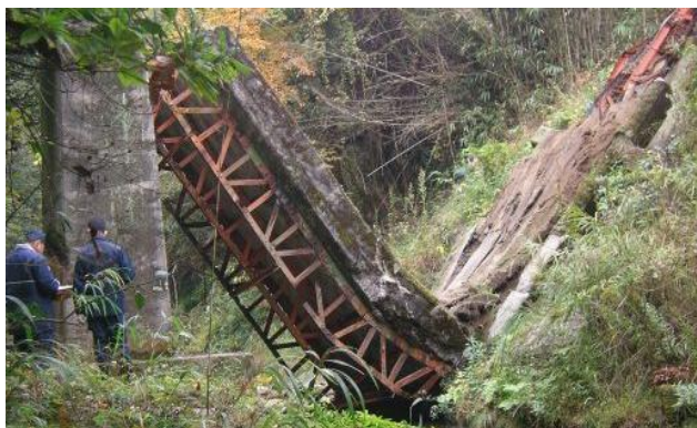
トラス橋の落橋(香川県・徳島県境 無名橋)
