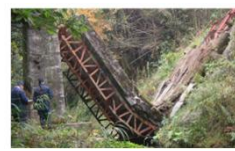
老朽化した橋梁の被害
