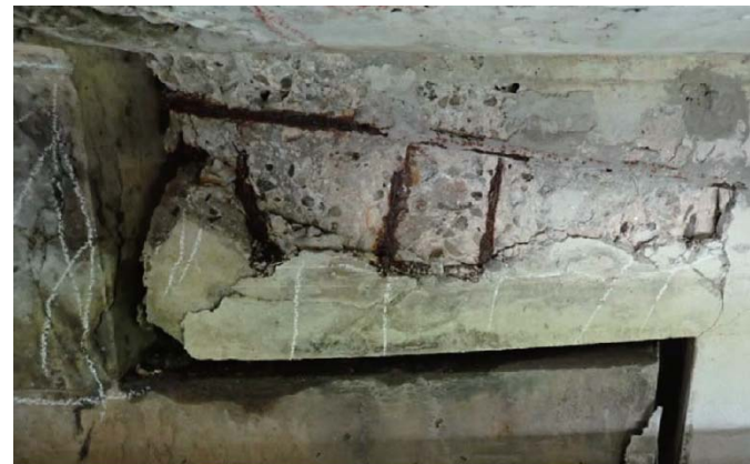
主桁の剥離・鉄筋の露出 (香川県東かがわ市 大川橋)
